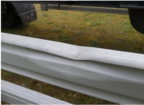
Unterfahrschutz links verformt
