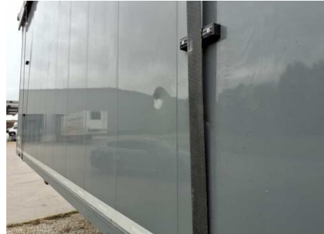
Wand Außen links Dellen
