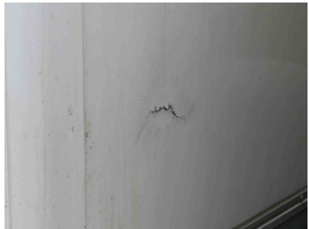
Beschädigung 8: Koffer: Stirnwandsegment - gebrochen / gerissen - instandsetzen und lackieren
