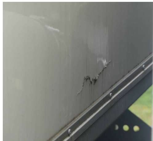
Beschädigung 8: Koffer: Stirnwandsegment - gebrochen / gerissen - instandsetzen und lackieren
