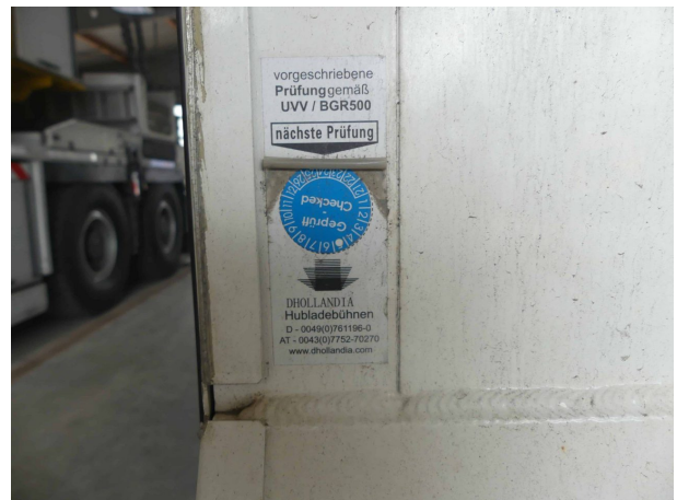
Beschädigung 1: Sonstiges: UVV LBW - fällig - durchführen
