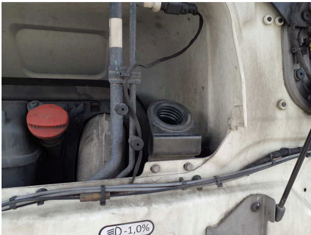
Beschädigung 3: Scheibenreinigung: Deckel Waschbehälter - fehlt - erneuern
