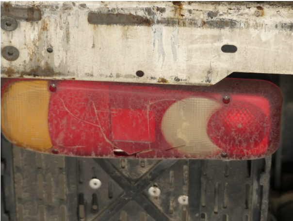
Beschädigung 6: Heckleuchte: Glas links (und rechts) - gebrochen / gerissen - erneuern
