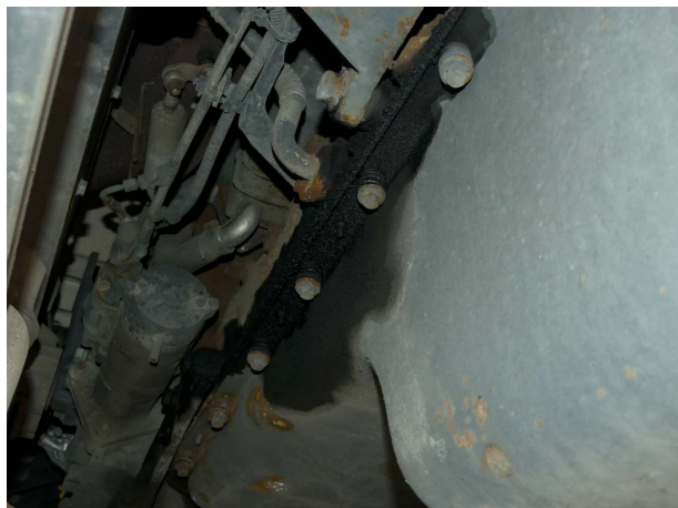
Beschädigung 9: Motor: Motor (Folgekosten möglich) - undicht - Diagnose durchführen
