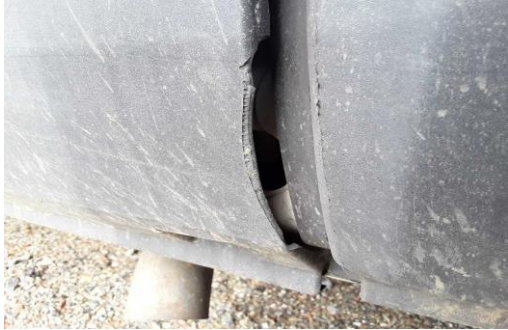
Beplankungen links gebrochen
