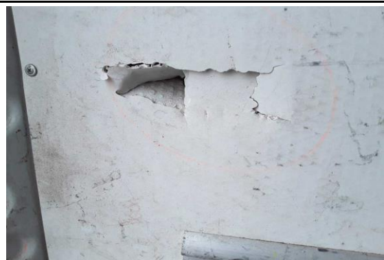
Verkleidungen im Laderaum gebrochen
