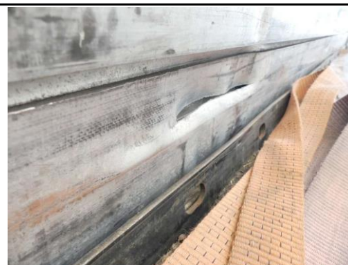
2 Alu Einstecklatten gebrochen/gerissen
