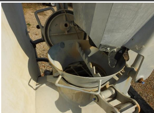
Ansicht Trichter Mischkessel
