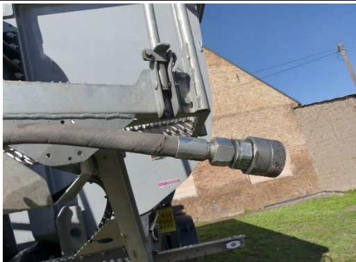
Schlauch Kippzylinder porös, gerissen
