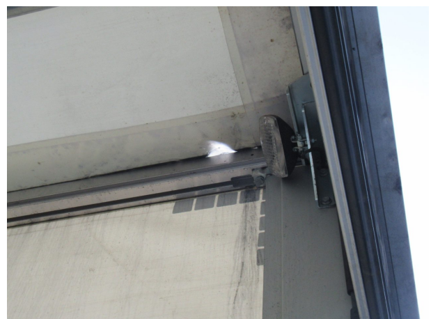
Beschädigung 5: Pritsche/Plane: Plane (Dach) - gebrochen / gerissen - instandsetzen
