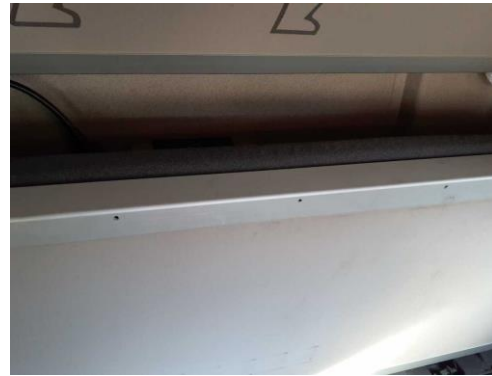
Liege unten Abrollsicherung fehlt
